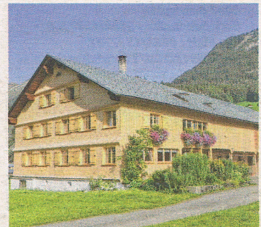
Otto und Reinelde Simma haben die Hausfassade nach dem Stil des ursprünglichen Wälderhauses saniert.
